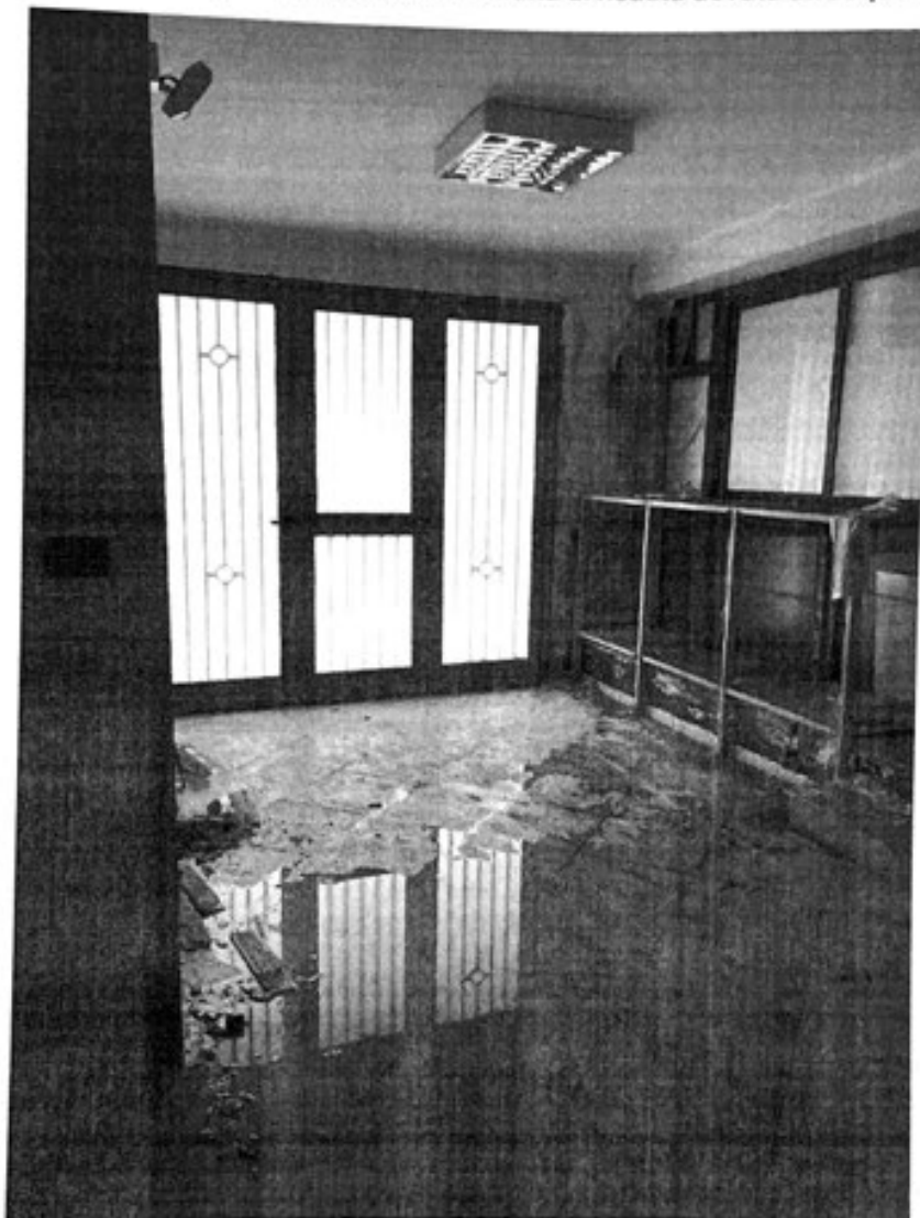
Presenza di acqua stagnante sul pavimento
